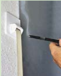
nachher Nach dem Einbau der Sanierungs- Gurtführung ist die zugige Schwachstelle eliminiert.
